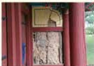
• 신문왕릉 건물 벽체 파손
