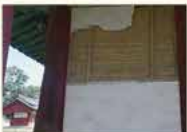
• 경주 향교 벽체 파손
