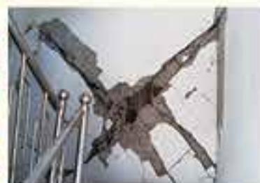
• 장량동 기예공 주택 내벽 파손
