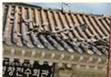
• 무형문화재 전수관 지붕 기와 파손
