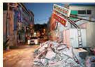
• 흥해읍 상가 외벽 난간 붕괴
