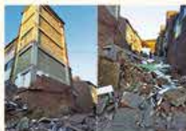
• 환어동 대동빌라 외벽 차장벽돌 탈락
