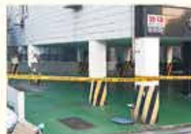
• 장량동 오서빌 필로티 파손
