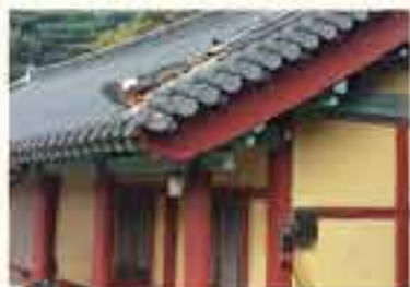
• 불국사 지붕 기와 파손
