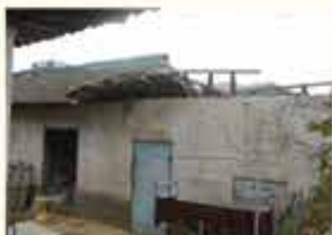
• 창고 지붕 파손
