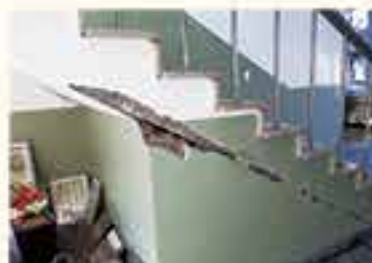
• 포항흥해공고 계단 균열
