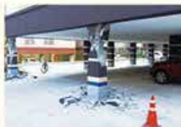
• 장량동 크리스탈 필로티 기둥 파손
