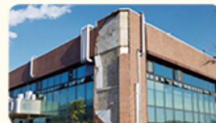
건물 외벽 탈락
