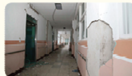
건물 내부 벽체 파손
