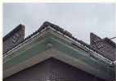
• 주택 지붕 난간 파손
