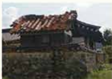
• 사마소 지붕 기와 파손
