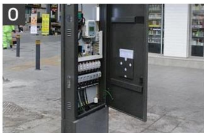
정보안내사인파통합형으로 설치된 가로등 제어함
