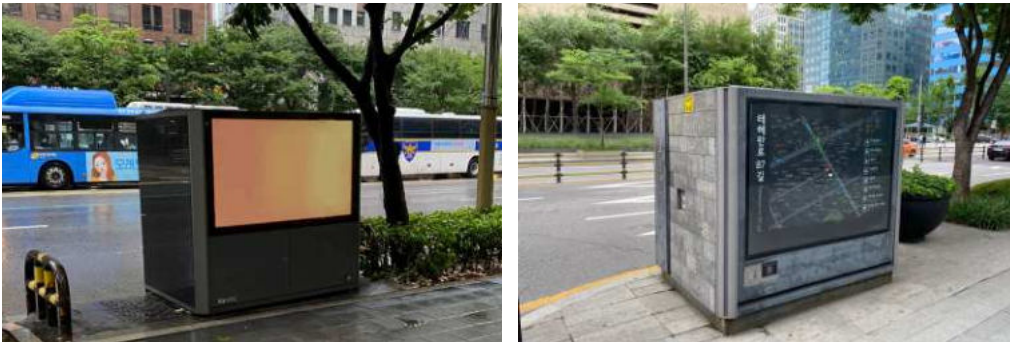
시설물 구역에 맞춰 심플한 형태로 설치된 배전함 사례
